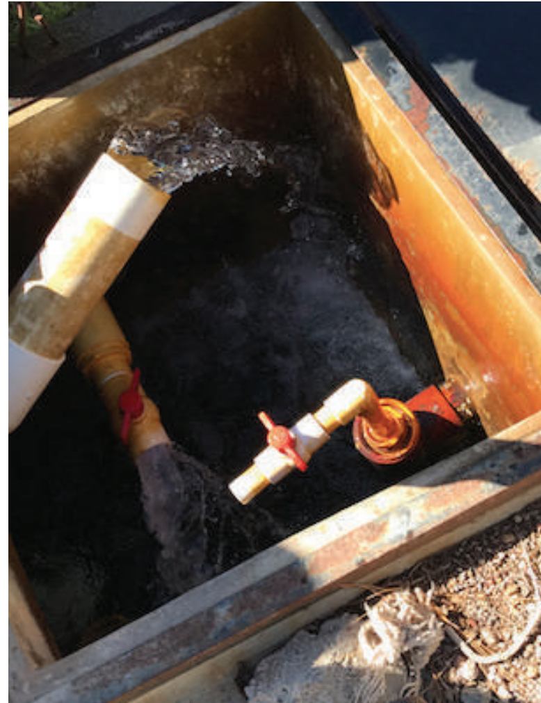
Fotografía 3: Tanque de distribución Linda Vista, San Rafael Las Flores
