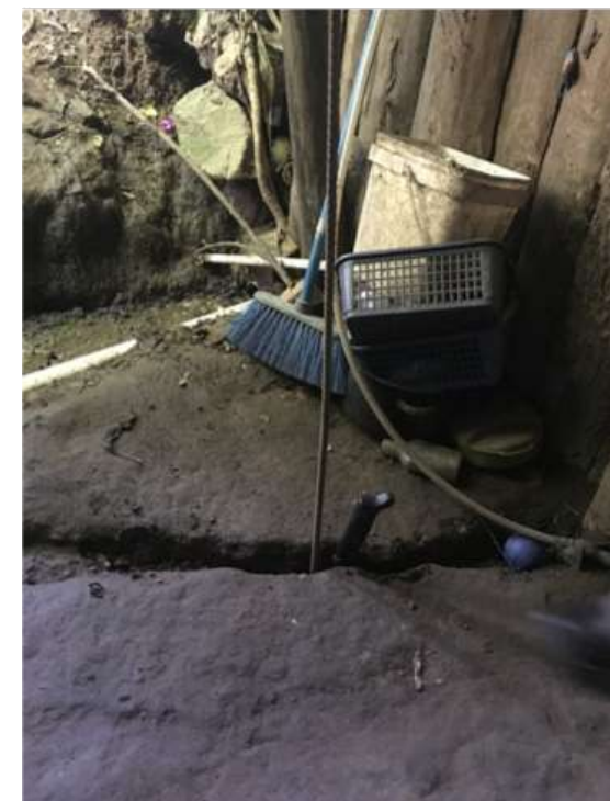
Fotografía 5: Piso de casa rajada, La Cuchilla
